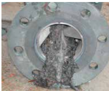
Obstrução típica num misturador da concorrência após menos de 5 horas
