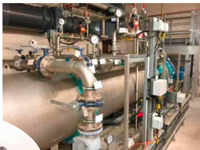
GDS instalado nas instalações do cliente
